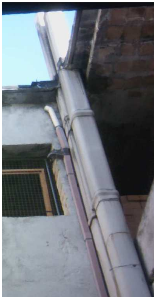
Figura 2 elemento vulnerabile non strutturale
